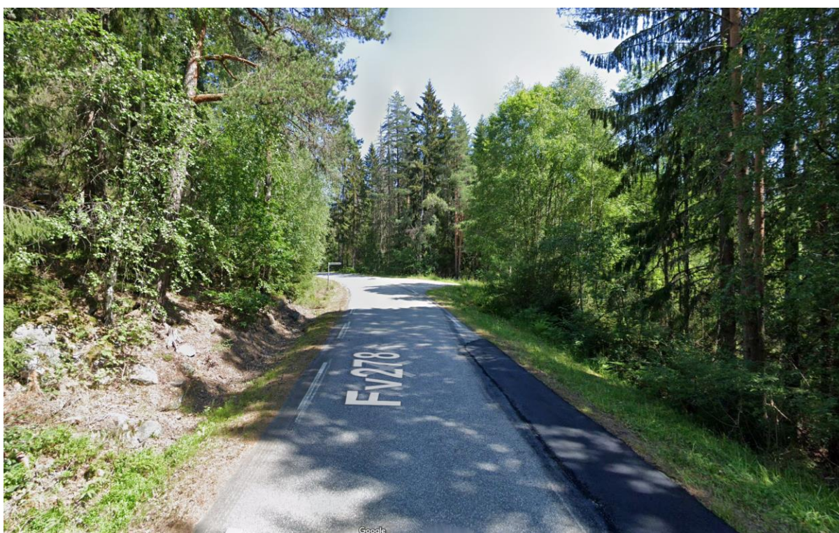
Figur 12 Et utsnitt fra fv. 3716. Veien har krappe svinger og er stedvis lappet på med ny asfalt. Kilde: Googlemaps/streetview
